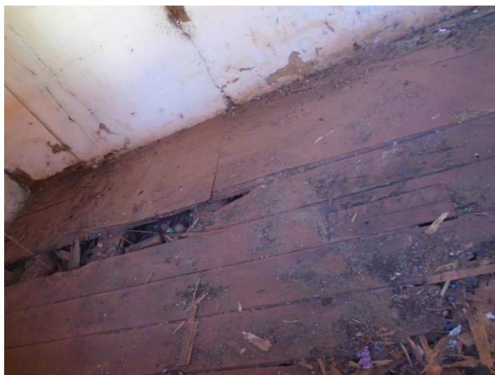
Figura 14. Piso tabuado de um dos cômodos apresenta material deteriorado e ausência de peças. Foto Raquel Córdova Christófar. Agosto/2020.
