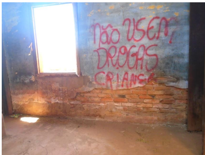
Figura 21. Internamente há paredes com alvenaria aparente e vão da janela desprovida de vedação. Foto Raquel Córdova Christófar. Agosto/2020.
