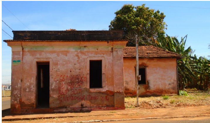
Figura 20. Fachada frontal desprendimento do reboco e alvenaria aparente. Foto Raquel Córdova Christófar. Agosto/2020.
