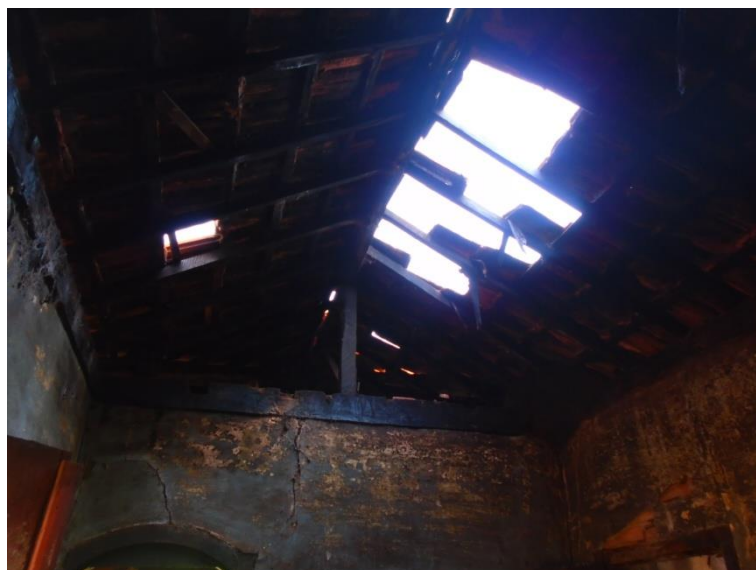
Figura 13. A cobertura está comprometida. Ausência de telhas e engradamento no cômodo que abrigou a cozinha da residência. Foto Raquel Córdova Christófar. Agosto/2020.
