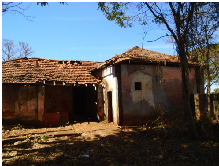
Figura 17. Fachada posterior. Ausência de telhas e caibros aparente no beiral. Foto Raquel Córdova Christófar. Agosto/2020.
