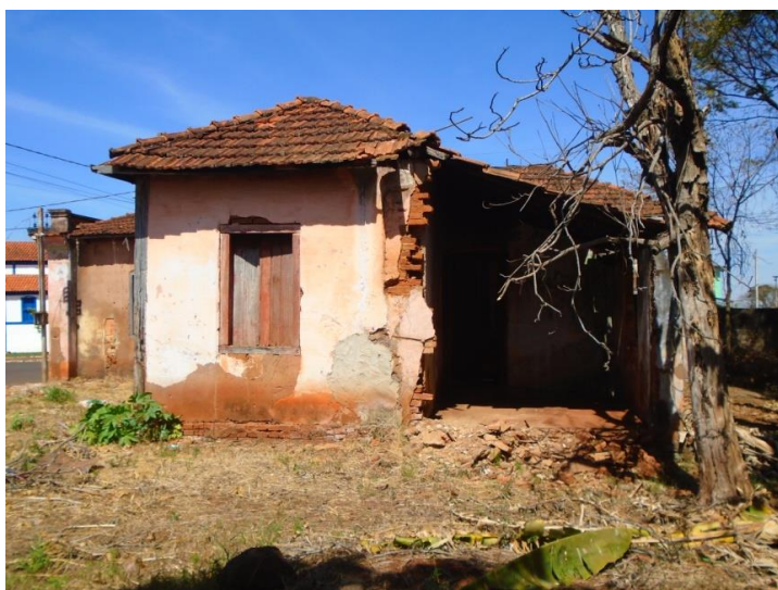
Figura 12. Fachada lateral esquerda. Detalhe da parede que desmoronou. Foto Raquel Córdova Christófaro. Agosto/2020.
