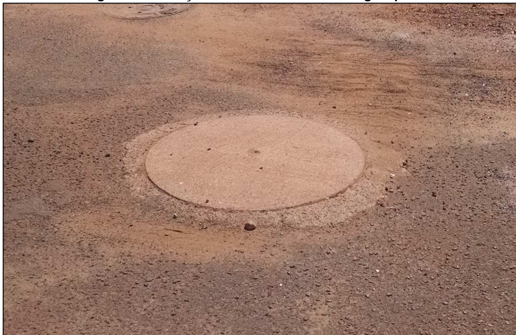
Figura 3.43 – Poço de visita de rede de drenagem pluvial.
