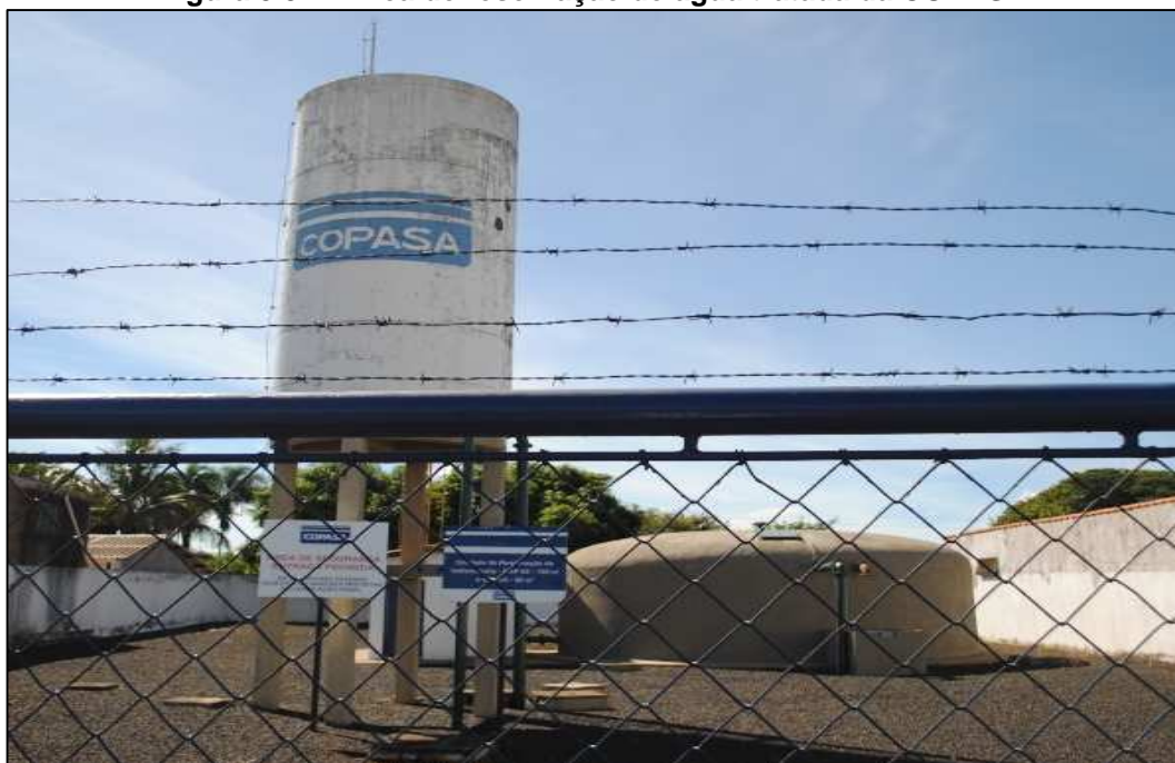
Figura 3.31 – Área de reservação de água tratada da COPASA.
