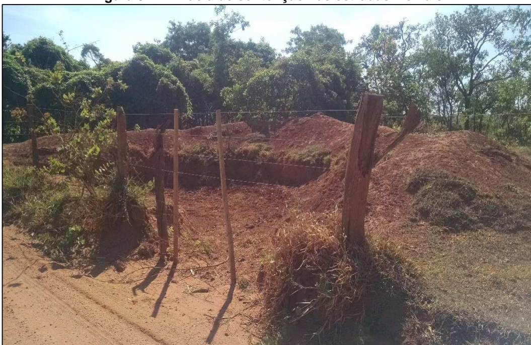
Figura 3.42 – Bacia de contenção nas estradas vicinais.
