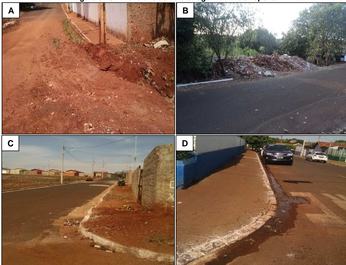
Figura 3.48 – Deficiências de drenagem de Indianópolis.
