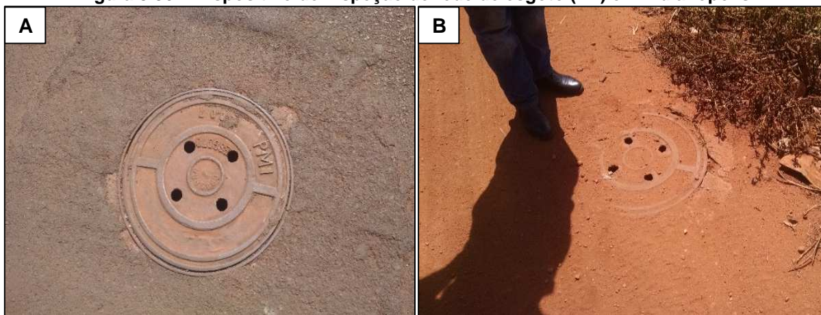
Figura 3.36 – Dispositivo de inspeção de rede de esgoto (PV) em Indianópolis.
