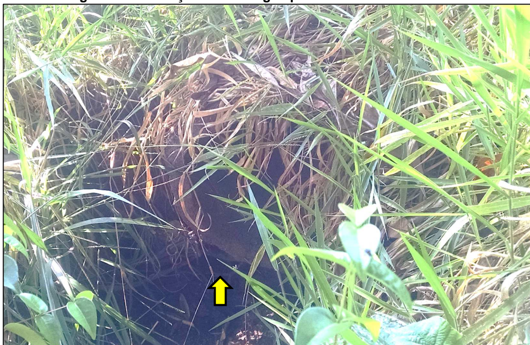
Figura 3.41 – Lançamento de água pluvial através de emissário.
