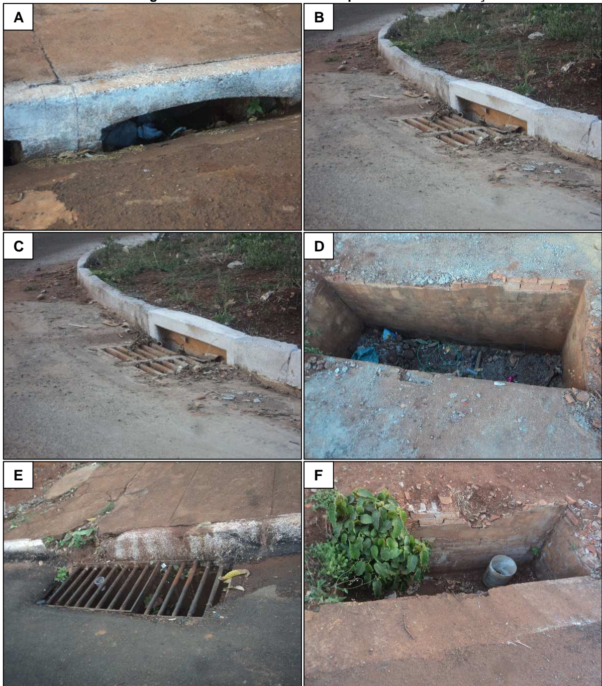
Figura 3.44 – Bocas de lobo com problemas de obstrução.
